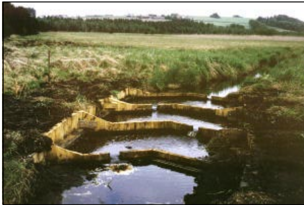
Foto 37. Fertige Sohlschwellen aus massiven Holzspundwänden; Randbereich des Wurzacher Rieds, Baden Württemberg. Fotos 35-37 D. Patalong, 1997.
