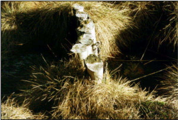
Foto 40. Manuell eingebautes Stauwehr in Schlitzgraben aus senkrechten Holzstämmen ohne Torfhinterfüllung: undicht. Spatenbräufilz, Lkrs. Bad Tölz-Wolfratshausen; 1/2002.
