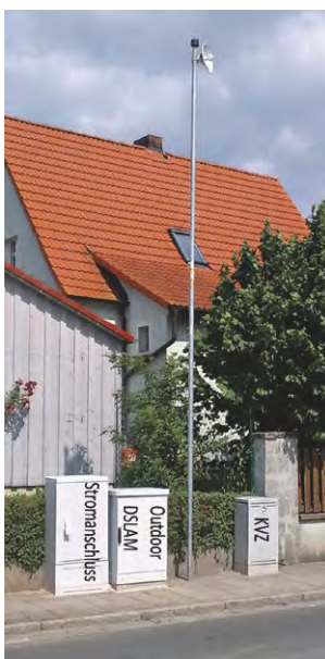
Abb. 67: Outdoor-DSLAM mit Richtfunktankbindung.
