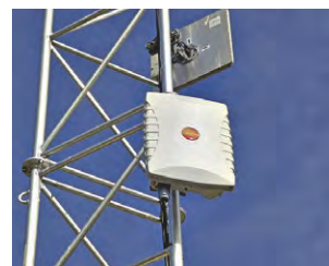
Abb. 69: WLAN-Richtfunksystem mit Flachantenne (5,8 GHz).
