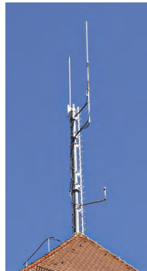
Abb. 64: TETRA-Mobilfunkmast mit Rundstrahlantenne.
