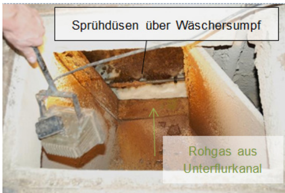
Abb. 34: Blick aus dem Unterflurkanal auf die Vorbedüsung im Wäscher
