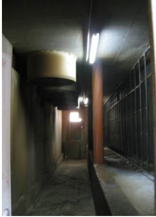
Abb. 17: Druckkammer mit Zuluft-ventilatoren und erster Filterwand (re) mit Wasser
