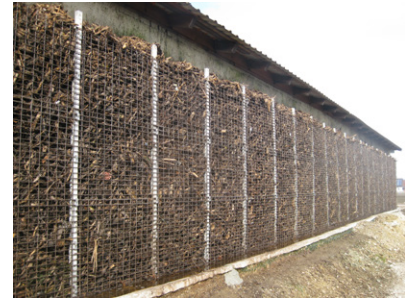
Abb. 19: Dritte Stufe Biofilter in Außenansicht an der Seitenwand des Stalles
