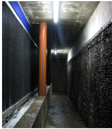
Abb. 18: Zweite Filterwand mit Säurestufe (II) sowie Biofilterwand innen (re)
