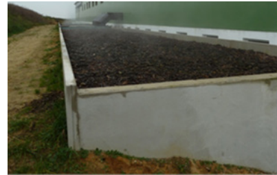
Abb. 78: Mit gerissenem Wurzelholz befüllter Biofilter A
