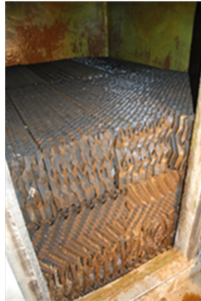
Abb. 35: Füllkörperelemente mit Biofilm (alter Zustand)
