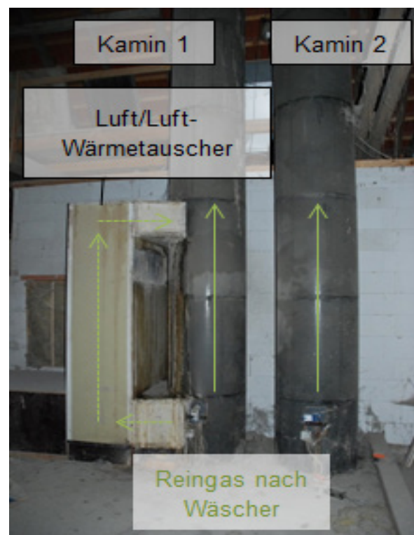
Abb. 33: Kamin 1 mit Abgasweg im Bypass über Luft/Luft-Wärmetauscher (gestrichelt) und Kamin 2 im Dachraum über dem Abgaswäscher
