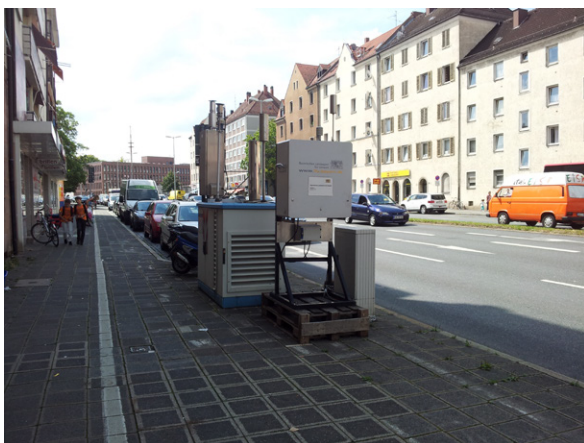
Abb. 18: Airpointer an der LÜB-Station
