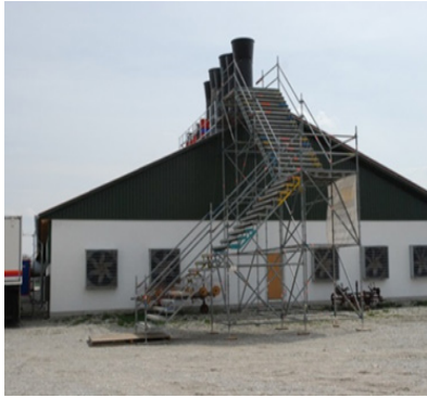
Abb. 11: Wandventilatoren 1 bis 5 an der Giebelseite
