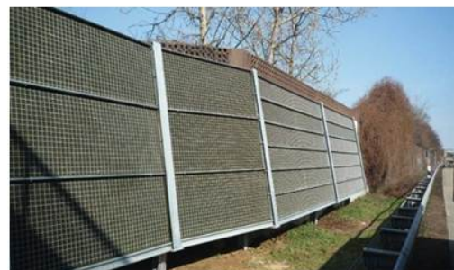
Mooswand mit Feinstaubfilterfunktion an der A61 bei Kruft Quelle: Landesbetrieb Mobilität Rheinland-Pfalz
