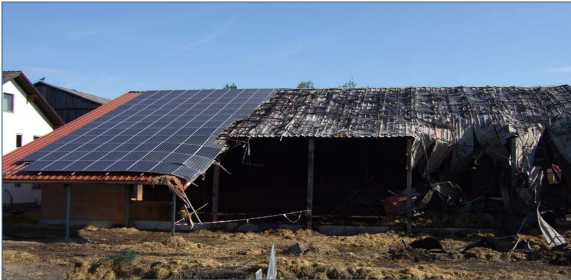
Abb. 1: Typischer Brandschaden einer Photovoltaikanlage 1
