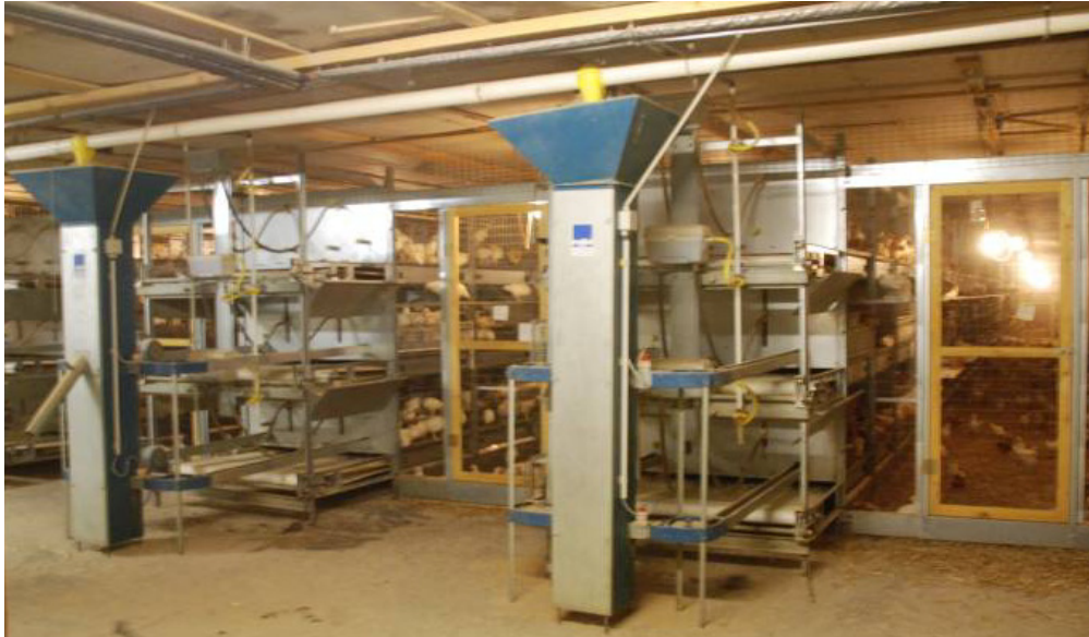
Abb. 1: Blick auf zwei Futterverteilstationen (Rohrleitungen und Schächte vom Futtersilo sowie Futtrinnen) mit den darunter liegenden Kotbändern der Junghennenaufzucht JH1.
