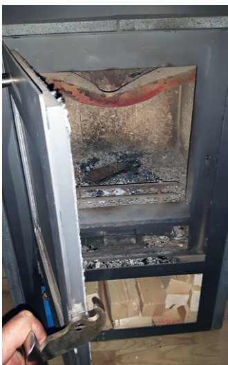
Verformungen im Kaminofen
