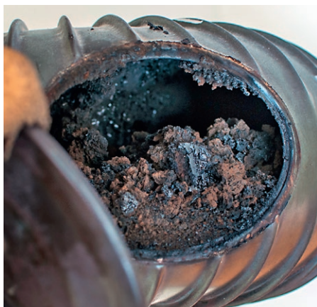
Rußablagerungen im Verbindungsstück behindern den Abtransport der Abgase
