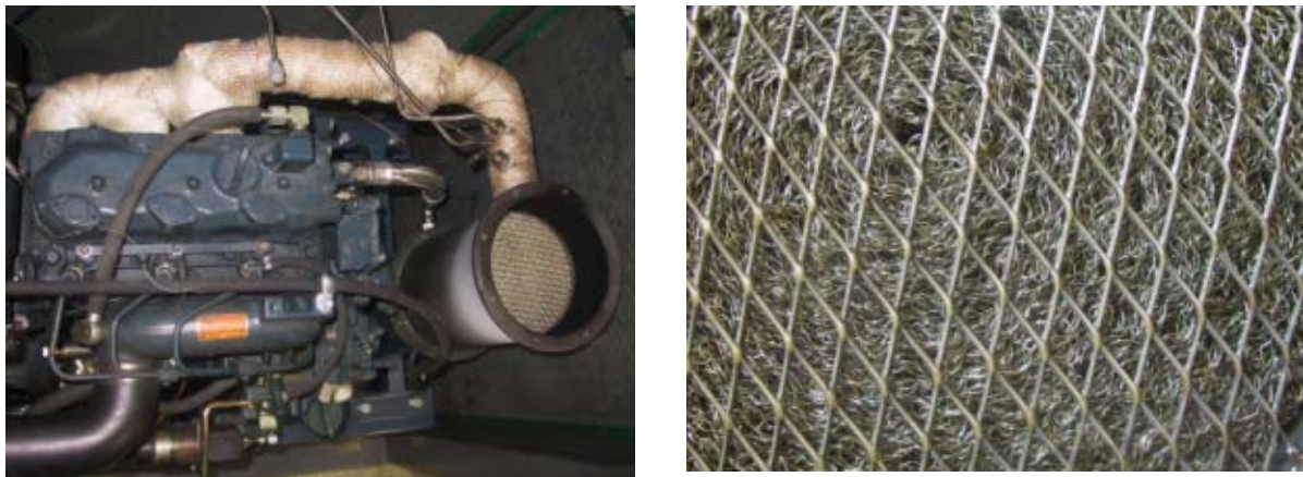
Abbildung 10: Filtersystem „Ba“ – eingebaut (links) - Detailansicht der Austrittsseite (rechts)
