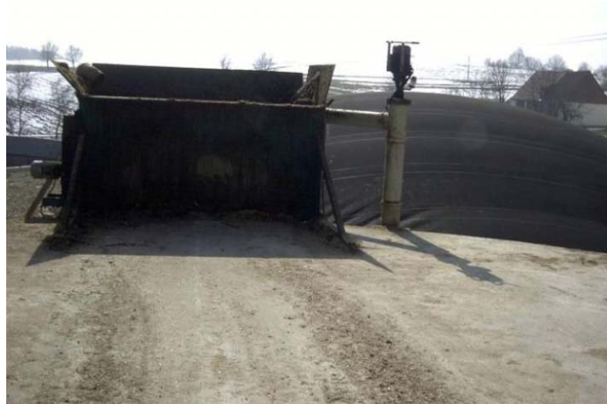
Abb. 1: Anlage I mit Fermenter, Nachgärbehälter, Gashaube und Vorrichtung zur Feststoffeinbringung
