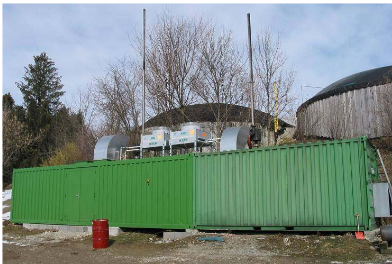
Abb. 4: Anlage IV mit BHKW-Containern, Fermentern mit Gashaube und Notkühleinrichtung
