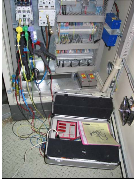
Abb. 13: Multimesh-Netzanalysator am BHKW-Schaltschrank
