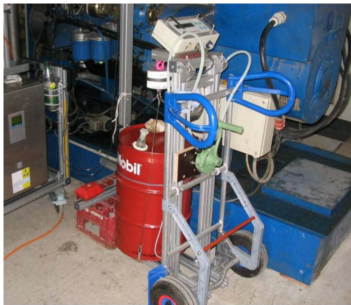
Abb. 11: Zündölwaage am Zündstrahl-BHKW
