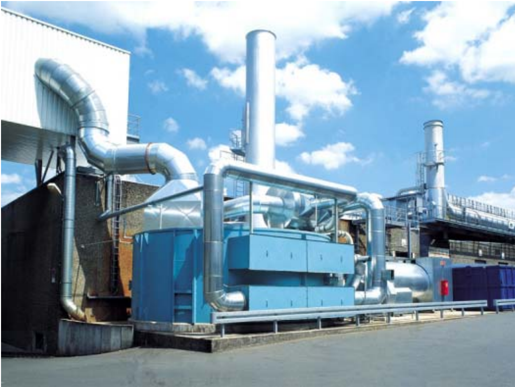
Abb. 7: Zur Abluftentsorgung bei einem Küchenmöbelhersteller wurden Adsorptionsrad und TNV kombiniert („Fotos EISENMANN“)
