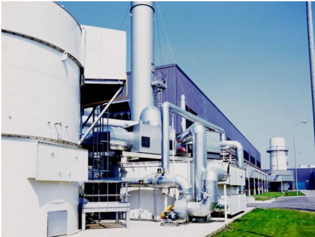
Abb. 6: Von der Automobilindustrie bevorzugt: Adsorptionsrad ADR plus RNV – hier in einem neu errichteten Pkw-Werk installiert („Fotos EISENMANN“)
