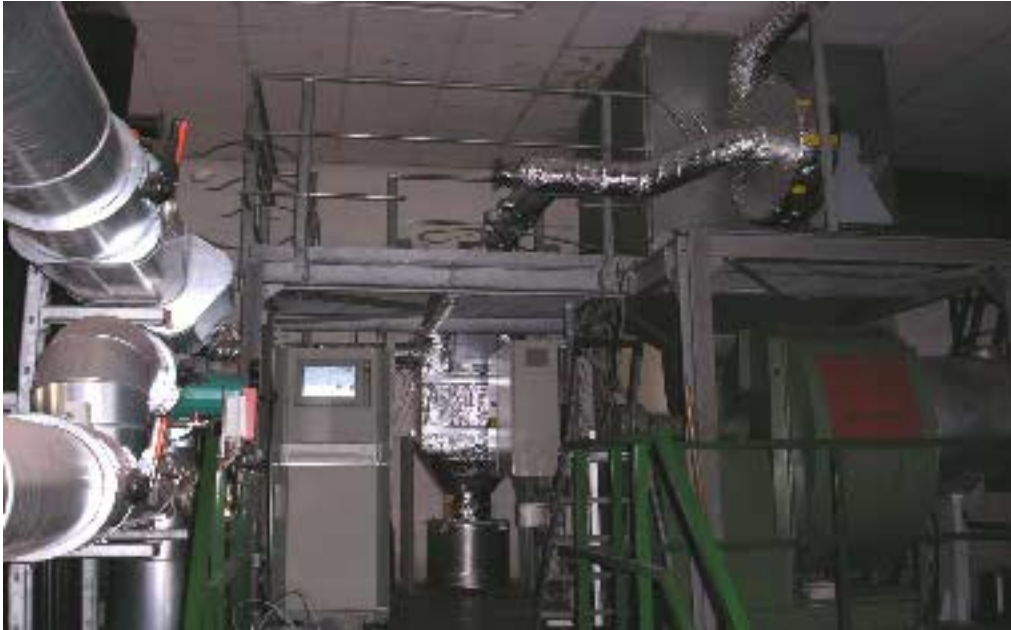
Bild 2.4-2: Standort der Teilstromversuchsanlage im Heizhaus
