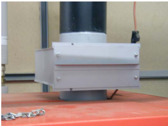
Abb.7: Über der Feuerungsanlage installiertes Filtergehäuse
