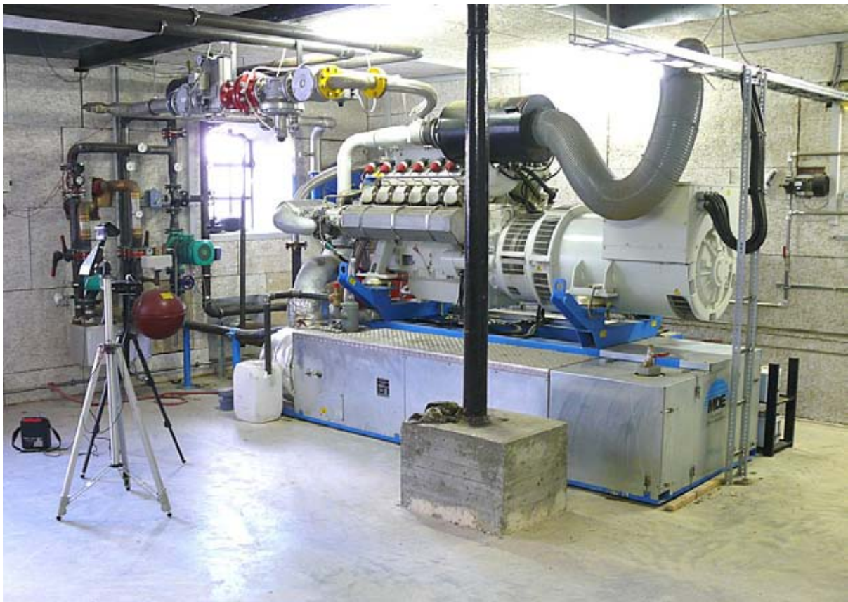
Abb. 22: Biogasmotor im Massivgebäude mit schallabsorbierender Wandverkleidung
