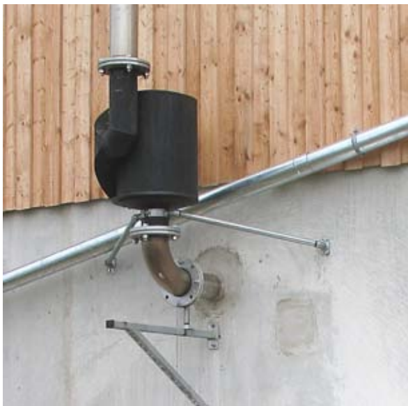
Abb. 24: Fugendichte Überfüh- rung der Abgasleitung vom BHKW-Gebäude ins Freie
