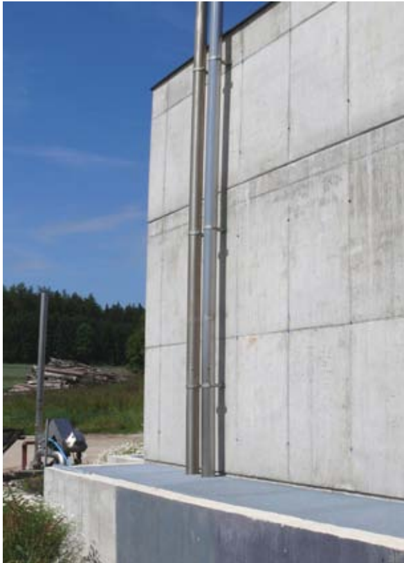
Abb. 26: Von der Gebäudewand entkoppelte Abgaska- mine, Luftkühler befin- det sich im Schacht unterhalb des Gitters
