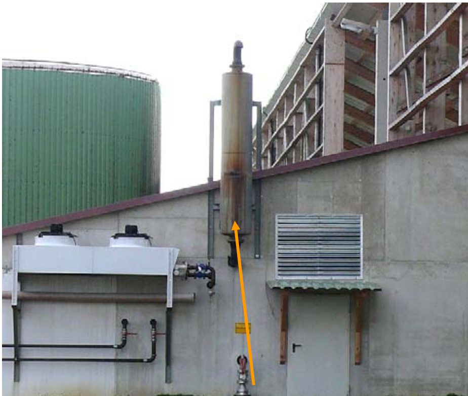
Abb. 20: Reflexionsschalldämpfer (Pfeil) an einer einmotorigen Biogasanlage
