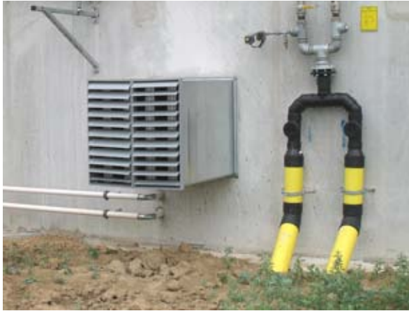
Abb. 23: Kulissenschalldämpfer mit Lamellen an einer Lüftungsöffnung eines BHKW-Gebäudes
