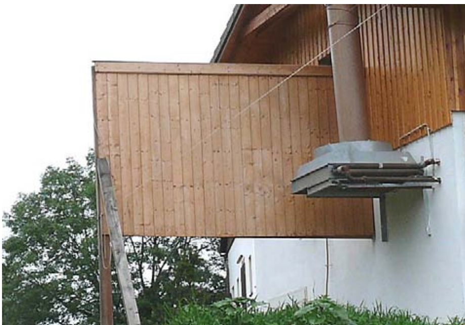
Abb. 25: Beispiel für einen ab- geschirmten Luftkühler am BHKW-Gebäude
