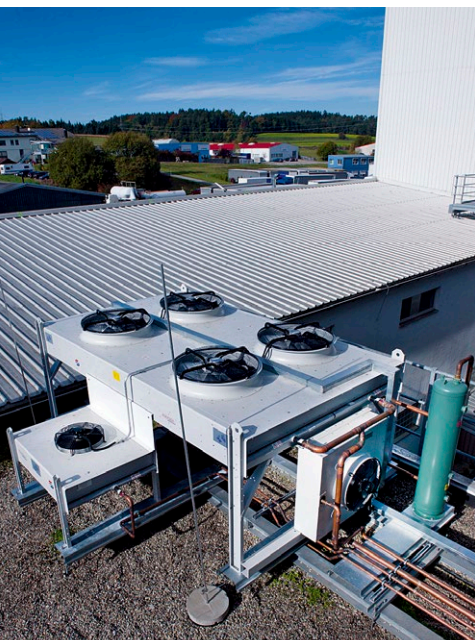
Verflüssiger mit luftgekühltem Wärmetauscher auf dem Dach des Unternehmens
