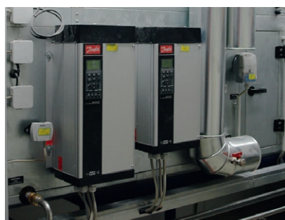
Frequenzumrichter ermöglichen einen Betrieb in Teillast.
