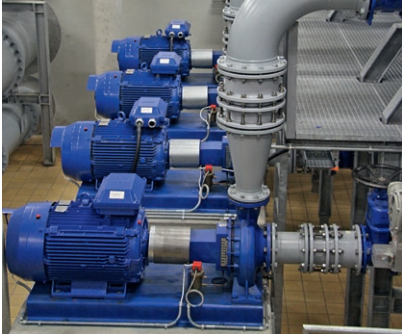
Optimierte Pumpensysteme können 30 Prozent Energie einsparen.
