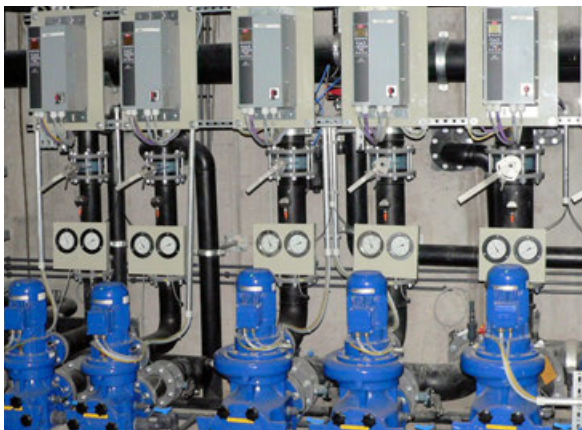
Abb. 21: Frequenzumrichter ermöglichen einen drehzahlgeregelten Betrieb von Pumpen
