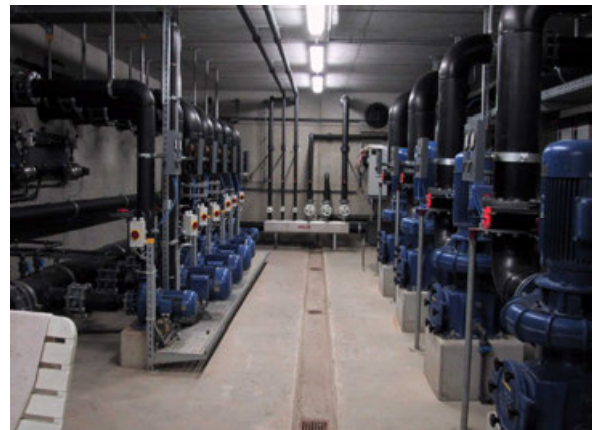
Abb. 22: Durch die Vielzahl an Pumpen in einem Schwimmbad besteht ein hoher Strombedarf.
