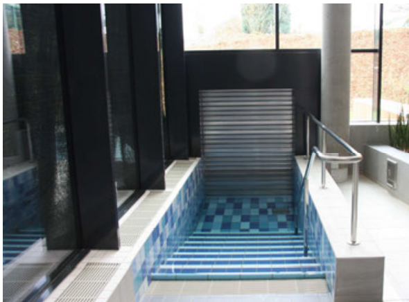
Abb. 17: Ein separat angeordneter Ausschwimmkanal mit Rollo als Abschluss reduziert die Energieverluste erheblich.
