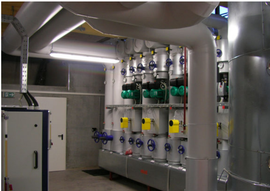
Abb. 26: Auch die Dämmung der Verteilungen ist wichtig.
