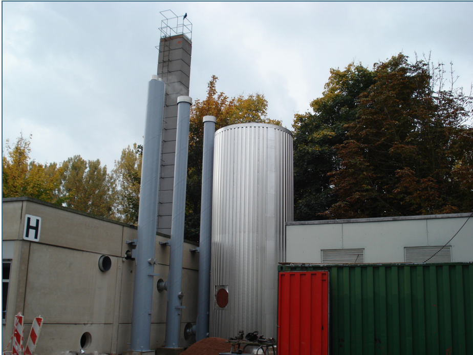
Abb. 21: Heizwasserpufferspeicher mit 50 m 3 Inhalt
