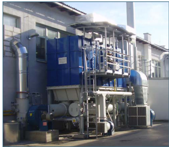
Abb. 12: Regeneratiive thermische Oxidation
