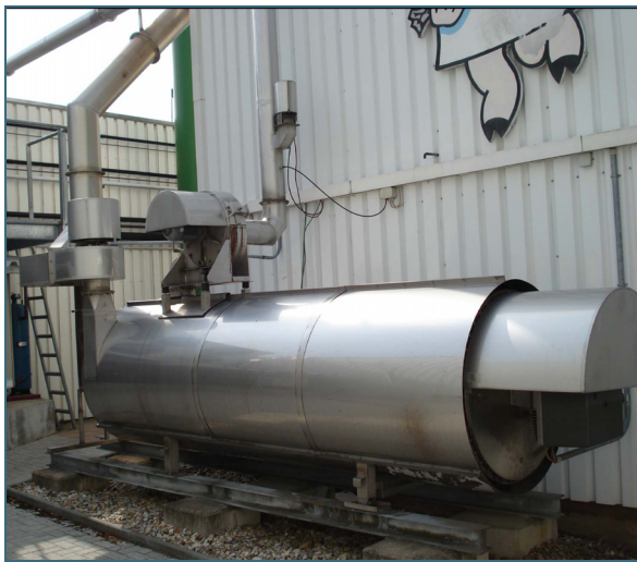
Abb. 11: Thermische Nachverbrennung von Räucher- rauch
