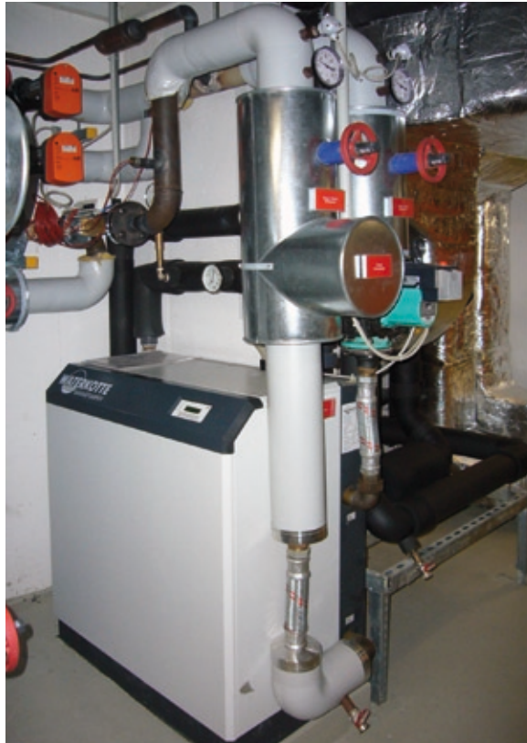
Abb. 06_02: Wärmepumpe in der Handwerkskammer-Akademie in Augsburg (Projektsteckbrief siehe Kapitel 9). Das Aggregat hat eine Wärmeleistung von 47 kW und nutzt das Grundwasser als Wärmequelle. [Quelle: Handwerkskammer-Akademie in Augsburg]
