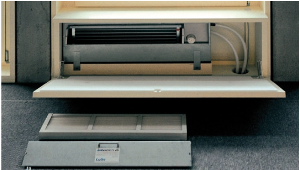
Abb. 03_04: Zuluft-Box im Bürogebäude Amstein und Walthert in Zürich. Die einströmende Zuluft (Hygiene-Grundlüf- tung) kann im Winter über einen eigenen, an das Heiz- system angeschlossenen Lufterhitzer vorgewärmt werden. Die eigentliche Raumheizung erfolgt über Betonkernaktivierung. [Quelle: Amstein und Walthert]
