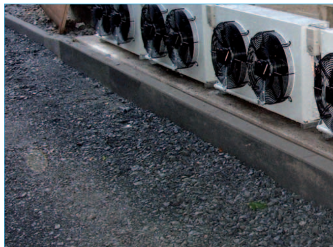
Der Standort von Verflüssigern neben einer Straße führt zu einer hohen Staubbelastung.
