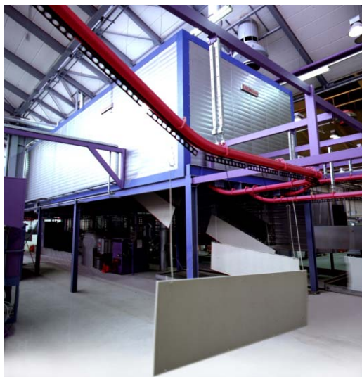
Abb. 13: Trockner mit A-Schleuse (Quelle: Eisenmann)
