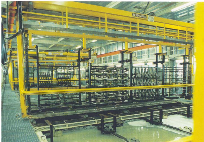
Abb. 6: Tauchvorbehandlungsanlage (Quelle: Eisenmann)
