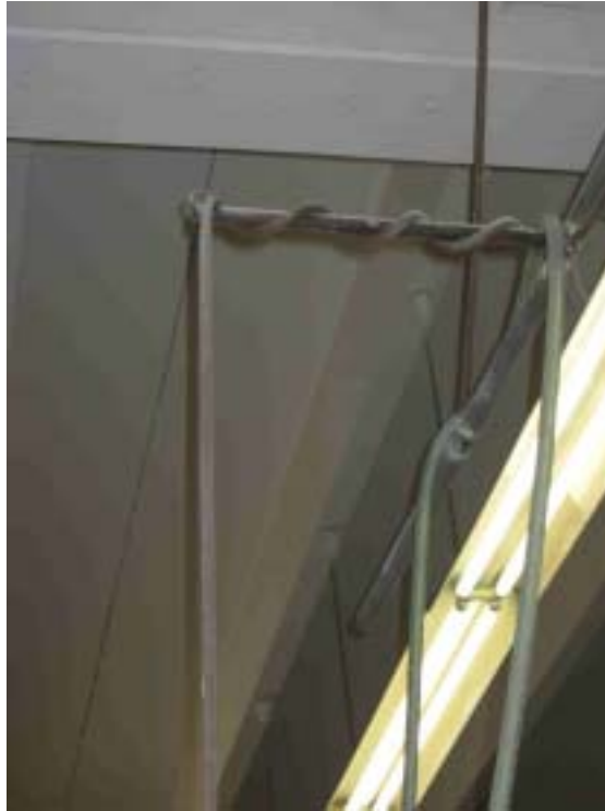
Abb. 10: Verschlungen verlegter Schlauch 1
