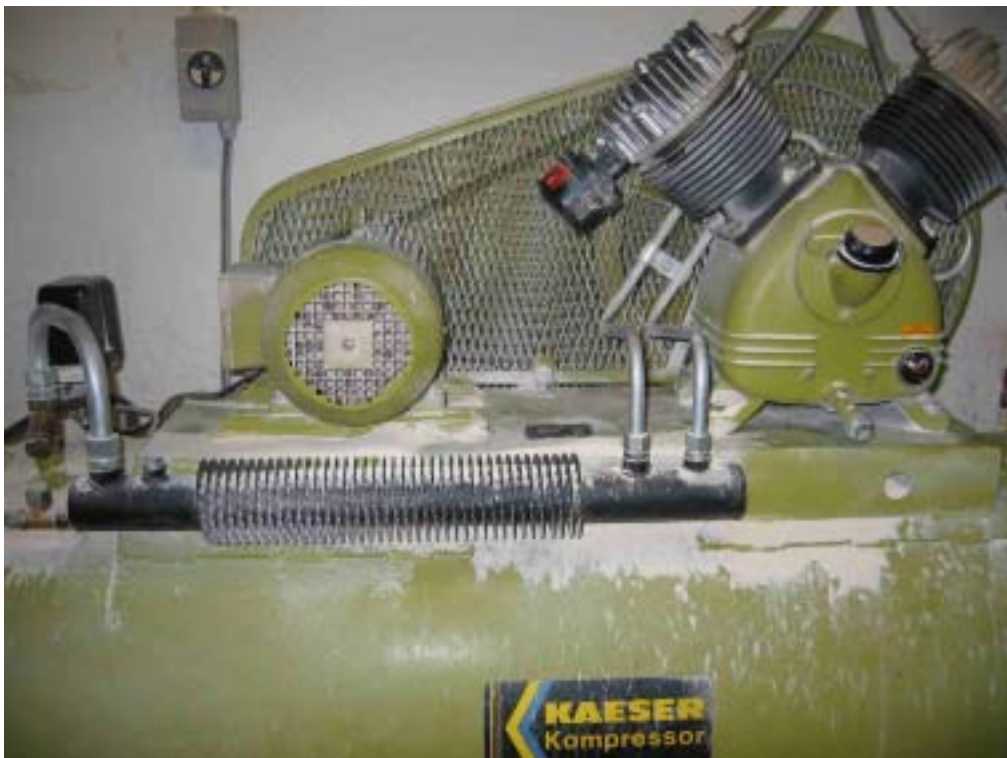
Abb. 18: stark verschmutzter Kolbenkompressor
