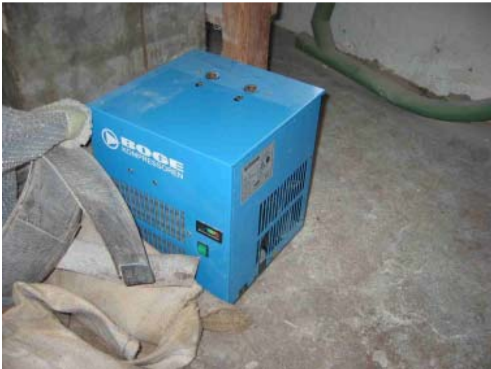
Abb. 7: Nicht angeschlossener Kältetrockner
