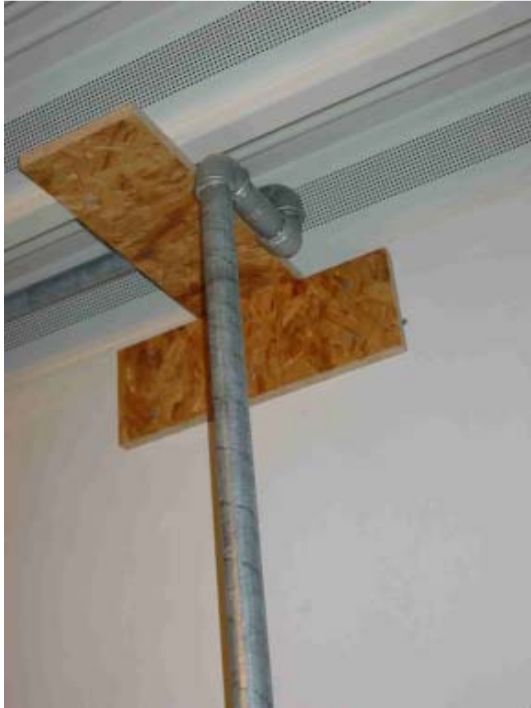
Abb. 12: Mehrfach verwinkelte Rohrleitungsverlegung
