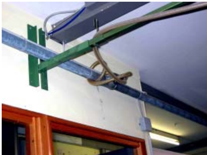
Abb. 11: Verschlungen verlegter Schlauch 2
