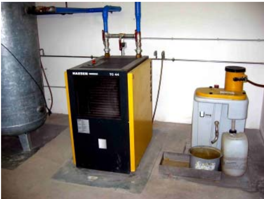
Abb. 22: Kondensataufbereitung der Druckluftstation mit Wärmeabführung
