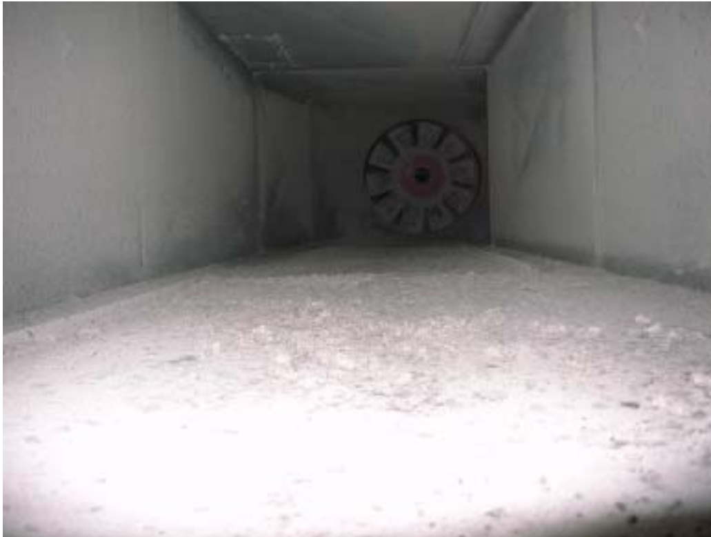
Abb. 27: Abluftkanal mit Ventilator, Oligomerablagerungen im Kanal
