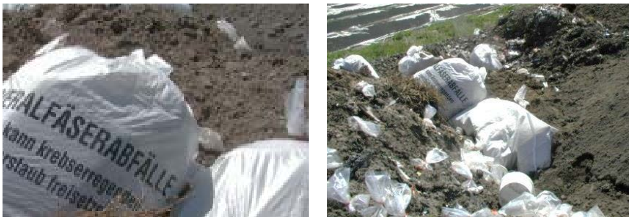
Abb. 7: Auch kleinere Mengen KMF-haltiger Abfälle müssen sofort in reißfeste und staubdichte Bigbags verpackt werden. Anschließend werden die Bigbags auf der Deponie eingebaut und überdeckt.
