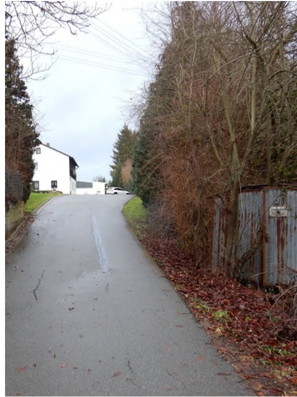
Abb. 14: Schäden an einem Weg im oberen Bereich eines Rutschhangs innerhalb der Estherienschiefer (Benk-Formation) im Landkreis Bayreuth.
