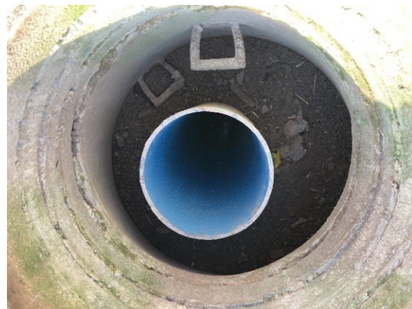
Abb. 2: Trichter T30, Blick ins Probenahmerohr (Kontrollrohr).
