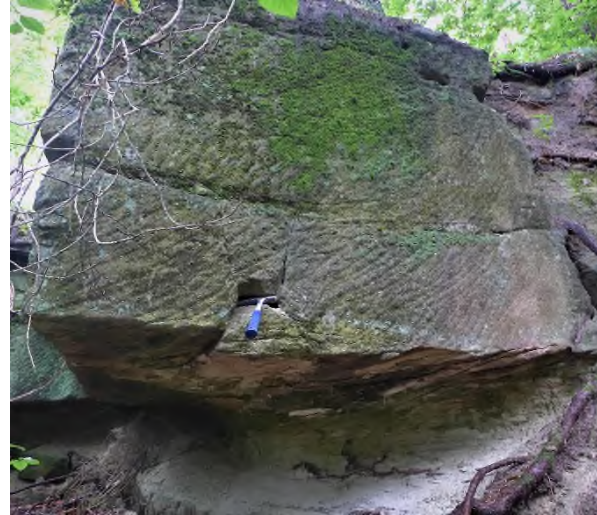
Abb. 14: Der Mittlere Bursandstein mit typischer mächtiger Bankung, hier im Aufschluss mit alten Abbauspuren in der Nähe von Fürth.
