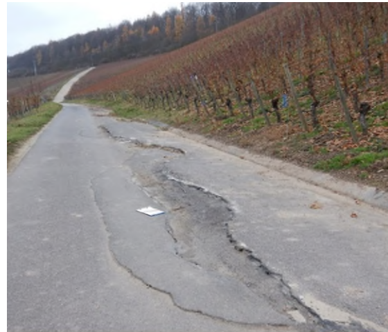
Abb. 19: Schäden am Weg in einem Weinberg im Oberen Muschelkalk im Landkreis Kitzingen
