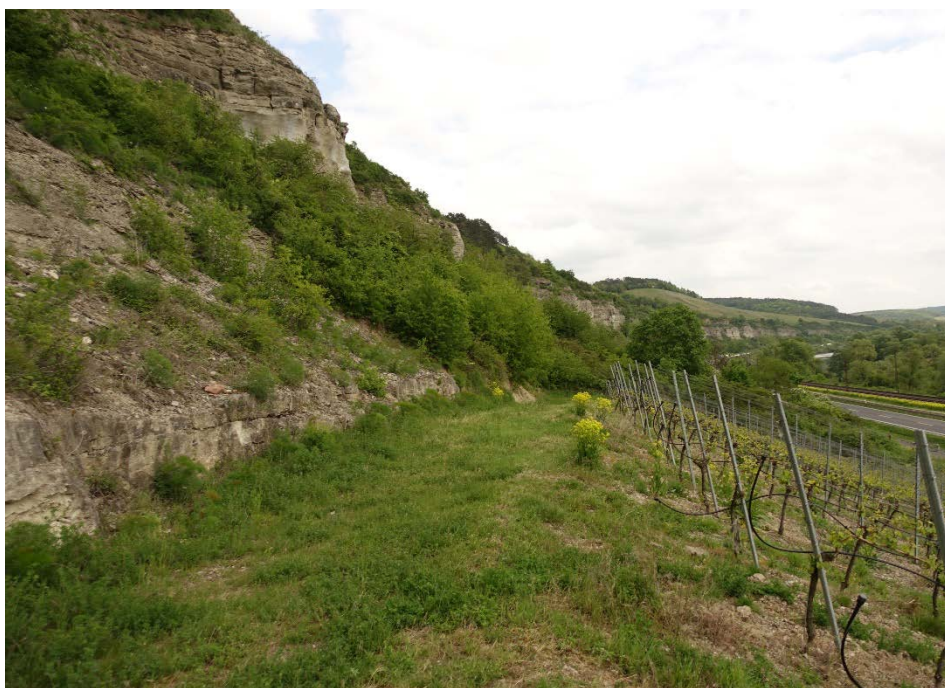
Abb. 13: Kalksteine des Unteren Muschelkalks bauen die Felswände entlang der B 27 südöstlich von Karlstadt auf. Die Felswände bilden potentielle Anbruchbereiche für Steinschlag.
