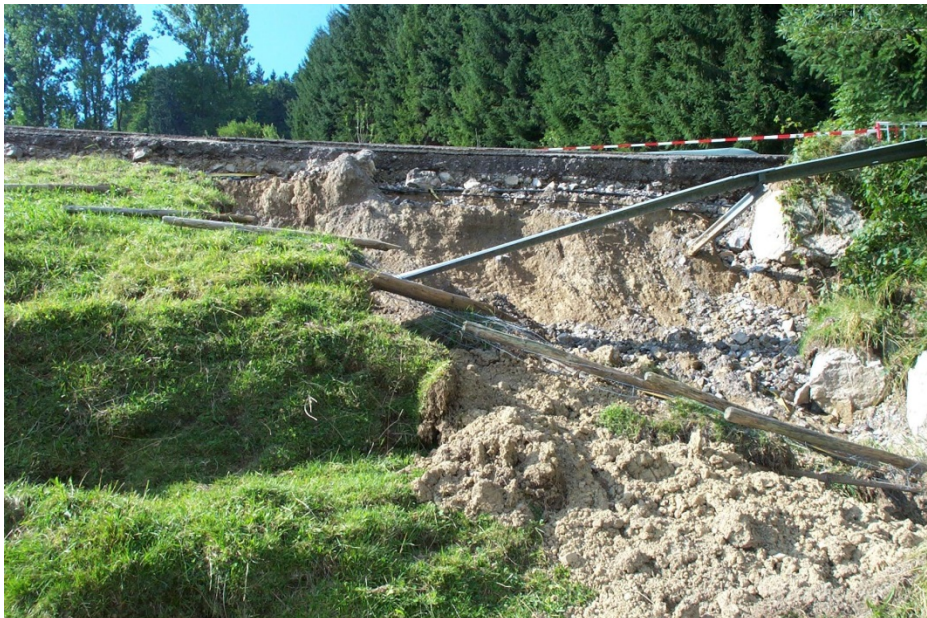
Abb. 25: Rutschung nördlich Hof bei Sonthofen
