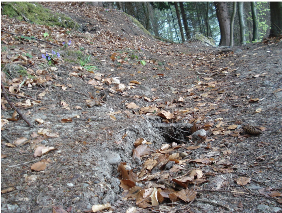
Abb. 23: Zugriss mit gespannten Wurzeln oberhalb des Anbruchbereichs einer Rutschung bei Immen- stadt
