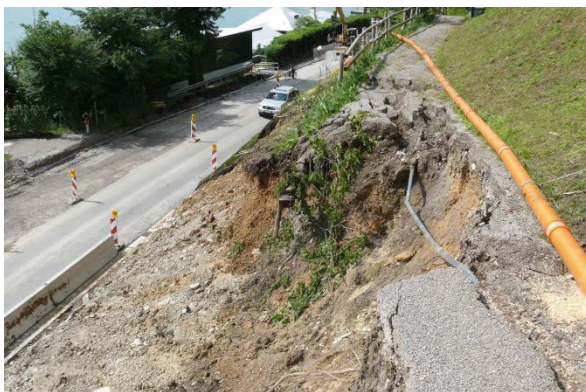
Abb. 7: kleinräumige Rutschung in Tegernsee
