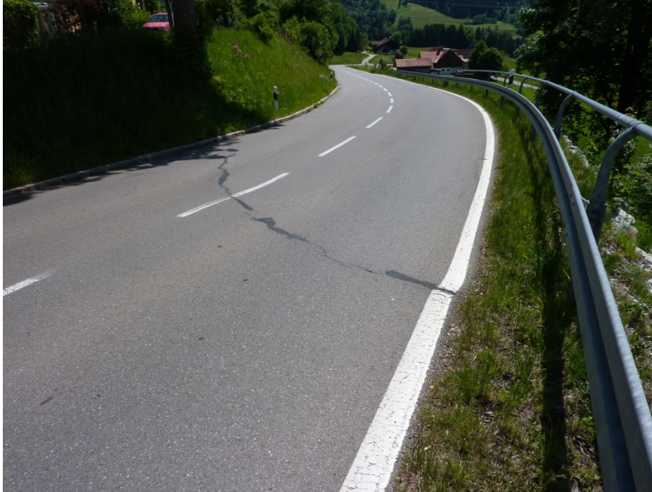
Abb. 13: Durch Rutschprozesse verursachte Risse in der Straße bei Neu- haus
