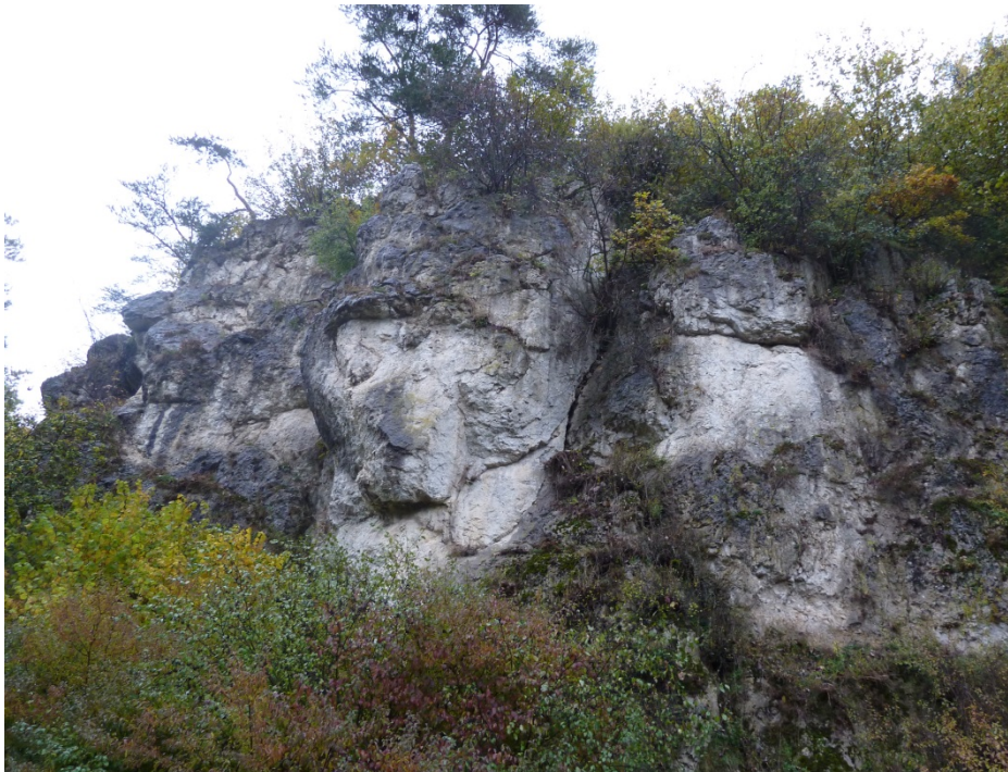
Abb. 14: Riffdolomit, der eine weitständige Klüftung aufweist und aus dem große Blöcke abstür- zen können.
