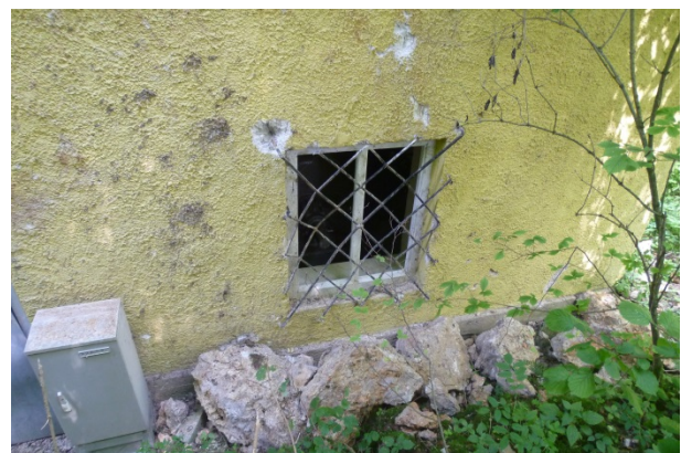
Abb. 4: „Glück gehabt“, nur Sachschäden – Steinchlaggefahr ist immer auch Lebensgefahr!
