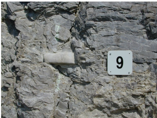
Abb. 3: Durch die Anbringung von einfachen und kostengünstigen Felssiegeln aus Zement können eventuelle Bewegungen an Klüften festgestellt werden. Solange das Siegel intakt ist, hat keine Bewegung stattgefunden. Ein Riss im Siegel kann auf eine Bewegung hinweisen, kann aber auch durch Temperaturspannungen o. Ä. entstehen. Die regelmäßige Kontrolle muss schriftlich dokumentiert werden (Kontrollbuch).
