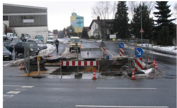
Abb. 8: Erdfälle können Versorgungsleitungen beschädigen. Andererseits werden sie manchmal von defekten Wasser- oder Abwasserleitungen ausgelöst.
