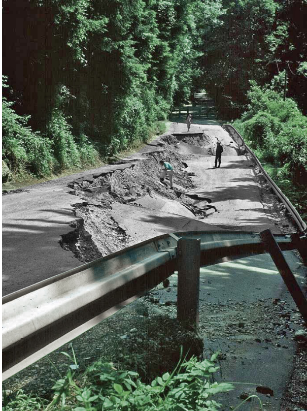
Abb. 5: Tiefreichende Rutschungen verursachen wiederkehrende Straßenschäden.
