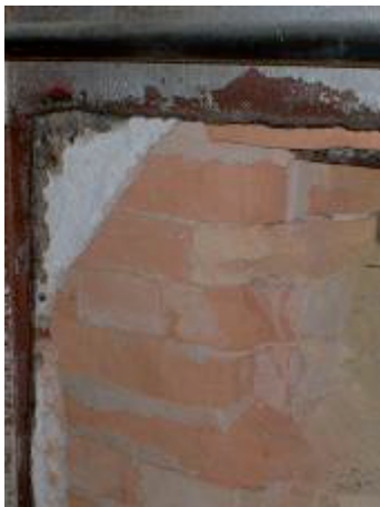
Abb. 36: Asbest-Dämmplatte („Promabest“) unter der Stahlkorsettierung eines Dekorofens (linker Bildausschnitt).
