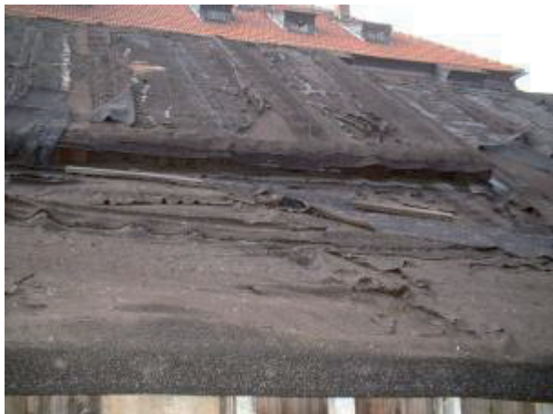
Abb. 35: Teerpappeeindeckung in Auflösung, aufgeklebt mit Teerkondensat auf Holzschalung.
