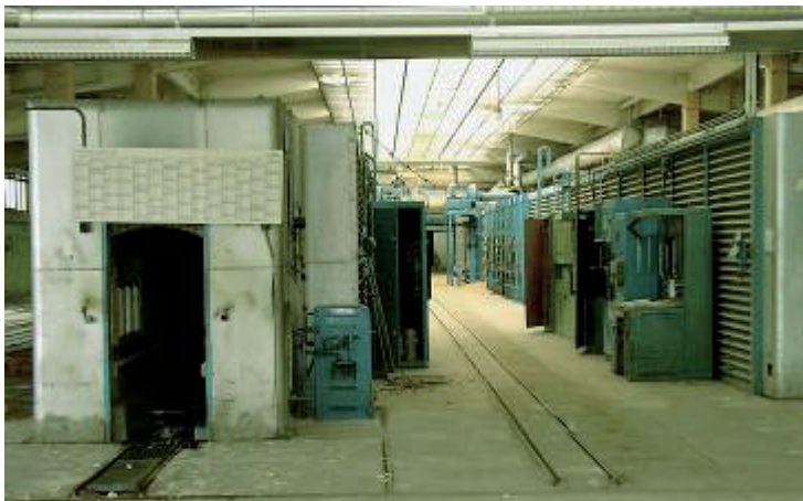
Abb. 14: Tunnelöfen mit Ofensteuerung („Monos“), Ofenhydraulik und Schubzylinder. Hintergrund die Brennzone mit Gaszuführung.
