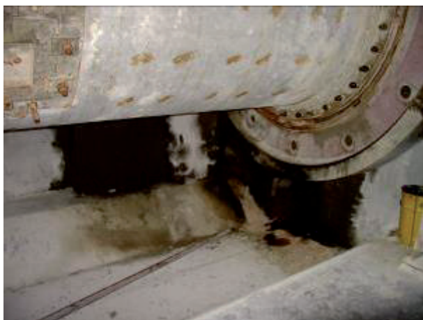
Abb. 21: Massive Schmierölverunreinigung in Bodenplatte und Fundament unter einer Kugelmühle der Masseaufbereitung.
