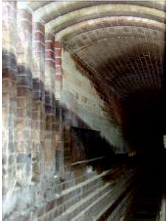
Abb. 31: Blick von der Ofeneinfahrt in die Aufheizzone eines Glattbrand-Tunnelofens. Als unterschiedlich gefärbte und scharf zonierte Flugstaubanhaftungen sind die bei abnehmender Temperatur aus der Ofenluft kondensierten verschiedenen Metalloxidausfällungen zu erkennen.
