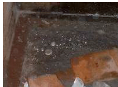
Abb. 27: Handhabungsbedingt ausgelaufenes, metallisches Quecksilber am Boden eines Schalt- und Schreibschanks der barometrischen Ofenluftsteuerung.
