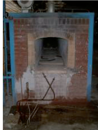
Abb. 24: Starke Hydrauliköl-Verunreinigung an der Einfahrt eines Dekor-Plattenschubofens. An der Einfahrt weiße, flugstaubartige Anhauchungen von Arsen- und Bleioxid.
