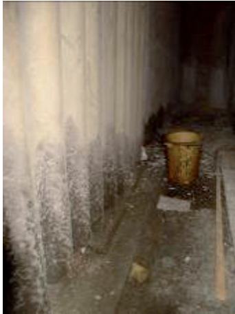
Abb. 23: Bausubstanzverunreinigung der Unterfahrt eines Tunnelofens durch langzeitige Tropfverluste aus einem Schubzylinder.
