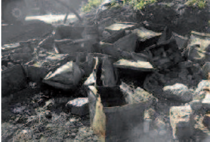
Abb. 28: Beim Rückbau eines Tunnelofens im Bereich der Brennzzone unter der Bodenplatte ausgebaute, teilweise noch mit Teerkondensat befüllte Teerschiffchen.
