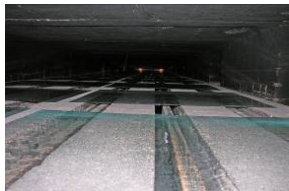
Abb. 8: Abkühllofen für Glasplatten
