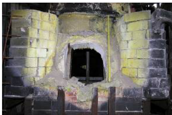
Abb. 11: Deutlich sichtbare Gelbverfärbungen durch Arsen im Bereich der Ofentüre
