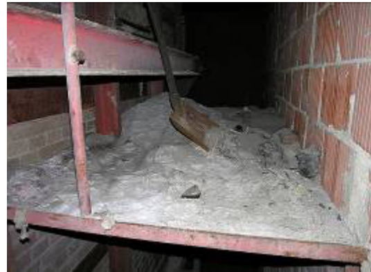
Abb. 10: Gemengelager in einer Industriehalle mit massiven Staubablagerungen
