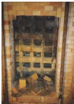
Abb. 12: Alter Regenerator mit Einschlichtung
