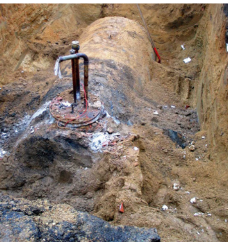
Risiken mindern – Altlasten sanieren (Bodenverunreinigungen an einem unterirdischen Öltank)
