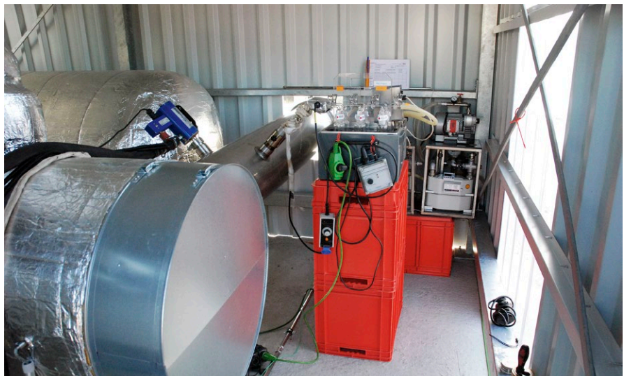
Rechts: Messplatz für Abgasuntersuchungen nach Behandlung im Oxidationskatalysator
