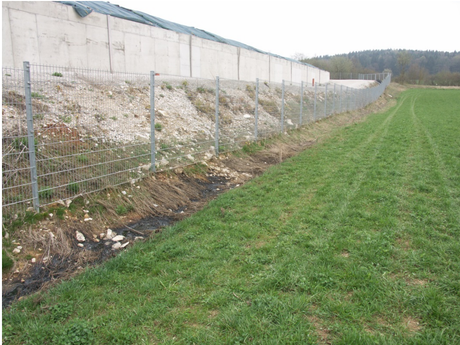
Abb. 8: Austritt von Silosickersaft unterhalb eines undichten Fahrstros
