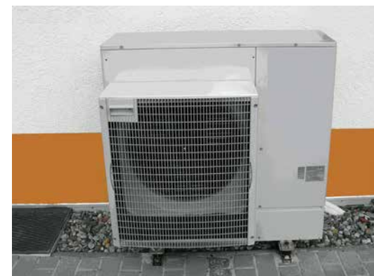
Luftwärmepumpen können eine Lärmquelle in Wohngebieten sein.
