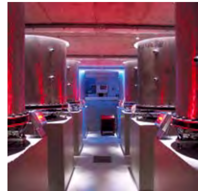
Blick in den Lysimeterkeller und Querschnitt durch die Anlage: Die acht Stahlzylinder mit den Bodenproben stehen auf Waagen, um die Zu- und Abflüsse von Sickerwasser zu messen. Das Sickerwasser wird auf Inhaltsstoffe analysiert.
