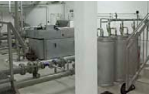
Kompakte Trinkwasseraufbereitungsanlage zur Uranentfernung
