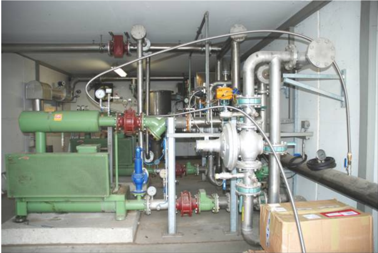
Abb. 5: Deponiegas-Aufbereitung (Kondensatabscheidung/Trocknung, Verdichtung) an der Deponie B (rechts vorne: Probenahmestelle PCDD/PCDF-Beprobung des Deponiegases)
