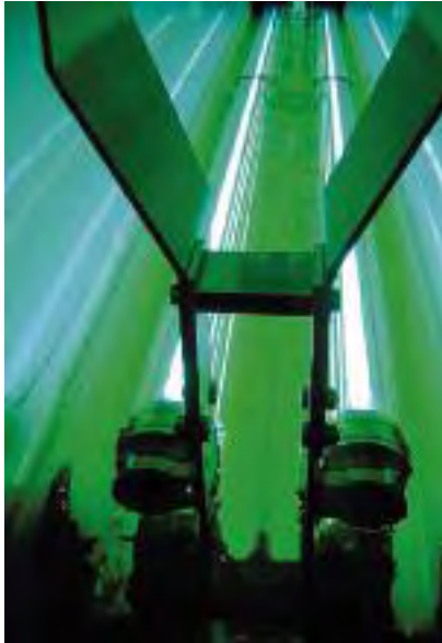
Abwasserdesinfektion mit UV-Strahlen
