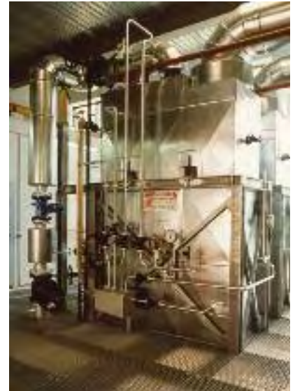
Wärmetauscher zur Kraft-Wärmekopplung im Abfallheizkraftwerk Augsburg
