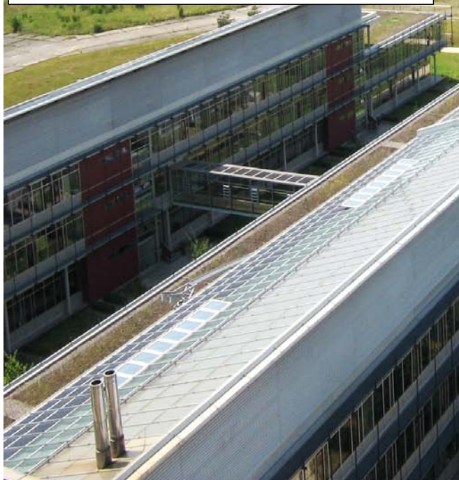
Dach mit Solarmodulen für Strom und Wärme
