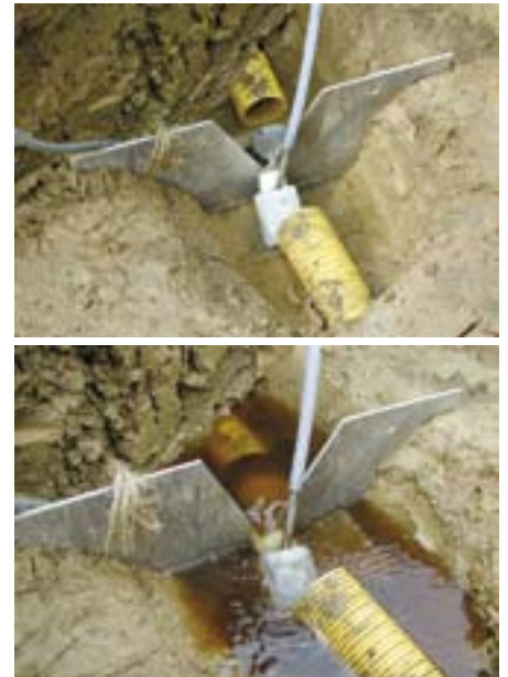
Geöffneter Dränstrang mit Messwehre Bild o.: unbelastet, Bild u.: belastet
