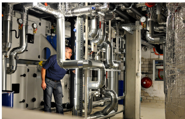
Energieeffizienter Betrieb der Klimaanlage
