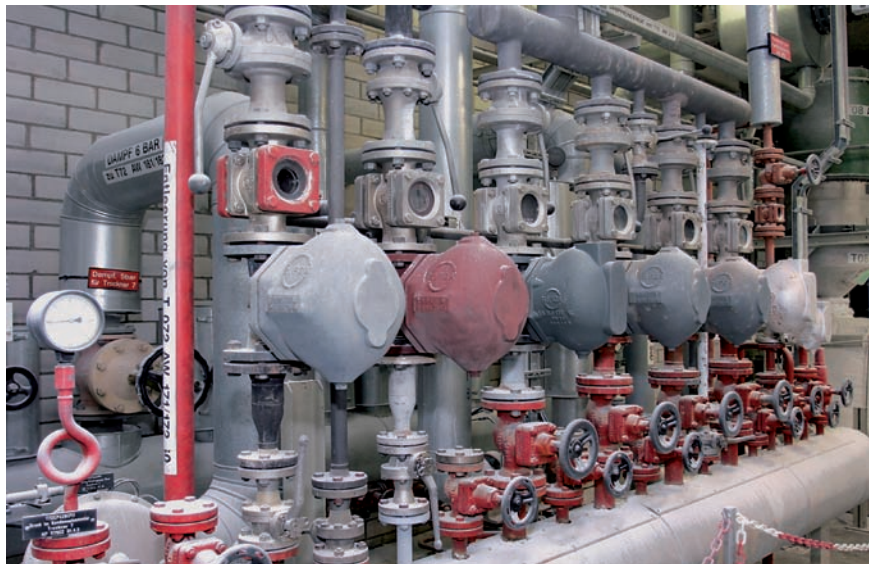
In der Kondensatsammelstelle wird das anfallende heiße Kondensat in Tanks aufgefangen. Die thermische Energie des Kondensats lässt sich mit Hilfe von Wärmetauschern fast vollständig nutzen.
