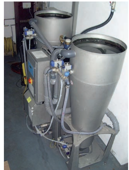
Wasseraufbereitungsanlage für die Autowäsche
