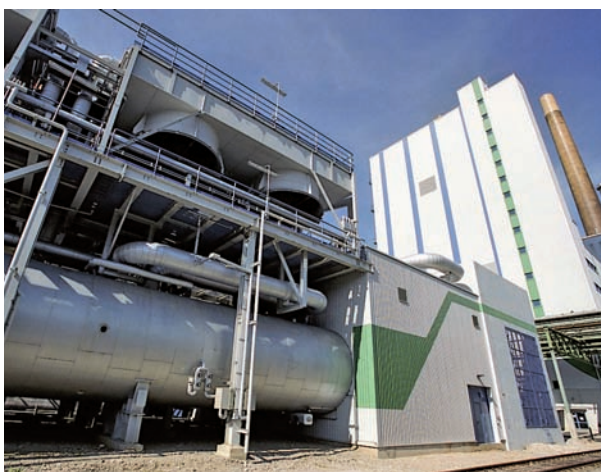
Das GuD-Kraftwerk in Kraft-Wärme-Kopplung versorgt die Wacker Chemie AG in Burghausen mit Energie.
