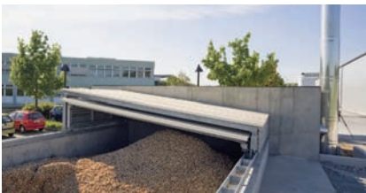
... fossile Energien ersetzen, z. B. durch eine Holzhackschnitzel-Anlage ...
